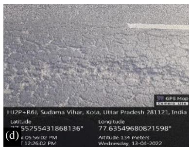
Figure 2. (d) Represents alligator cracking.
